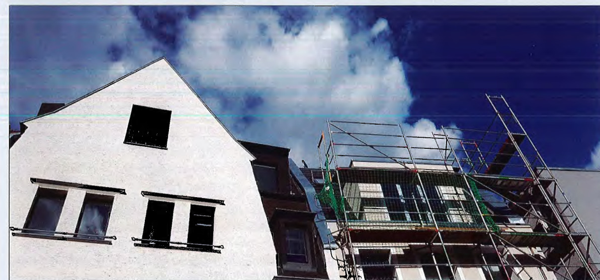
Wenn wegen der Vorschriftenlage Sanierung oder Umnutzung von Bestandsgebäuden unwirtschaftlich werden, ist das Grund zur Besorgnis (Foto: VdS)
